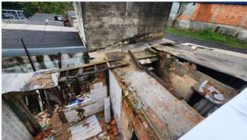
Figuras 8 e 9 – Fotos tiradas pelo corredor da casa nº 6 (vizinho da casa a ser demolida) – nas fotos acima é possível notar a situação precária da casa a ser demolida, sendo que parte da sua estrutura já colapsou.
