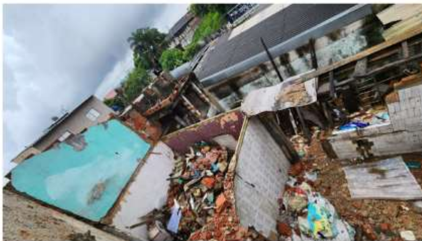
Figuras 6 e 7 – Fotos tiradas pelo corredor da casa nº 6 (vizinho da casa a ser demolida) – nas fotos acima é possível notar a situação precária da casa a ser demolida, sendo que parte da sua estrutura já colapsou.
